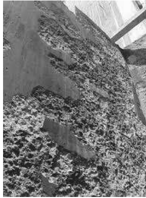
Figura 4. Pëlcitja e betonit [1]
