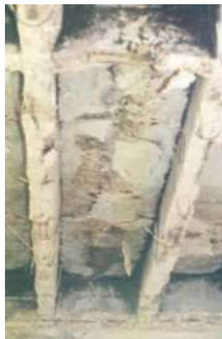
Fig. 19. Ndikimi i defekteve në shkallën e dëmeve nga zjarri në sistemin e dyshemesë së tabanit
