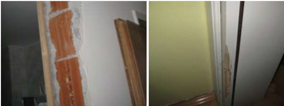
Figura 12. Dëmtimet e kornizës në derën së banjos dhe kornizat e dyerve të dhomës së gjumit
