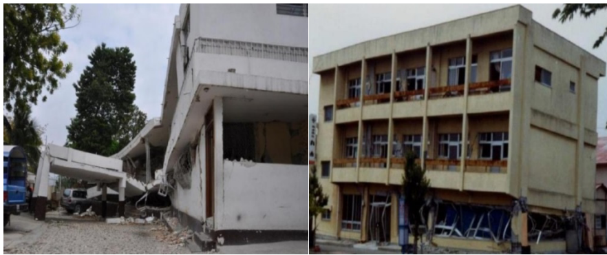
Сл. 1. Срушени нерегуларни конструкции во основа при дејство на земјотрес
