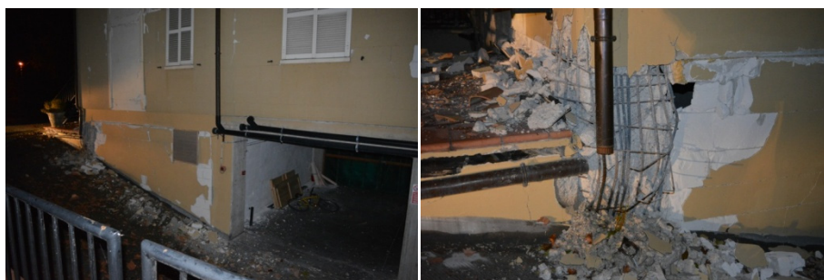
Сл.20. Ршење на краток столб на АБ објект во Норчија по настанот со М6.5
