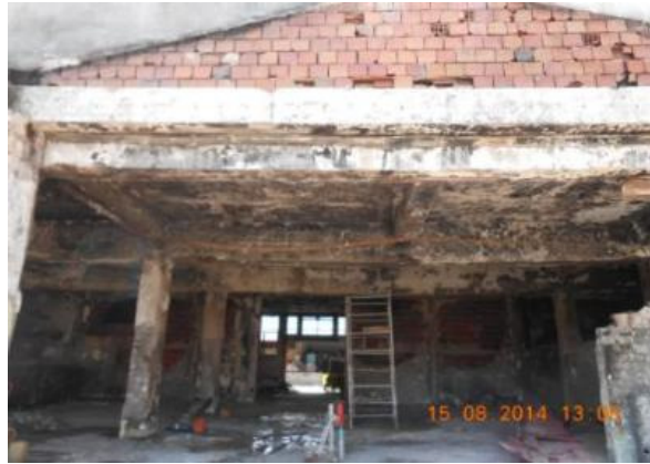
Сл. 2. Изглед на опожарен индустриски објект
