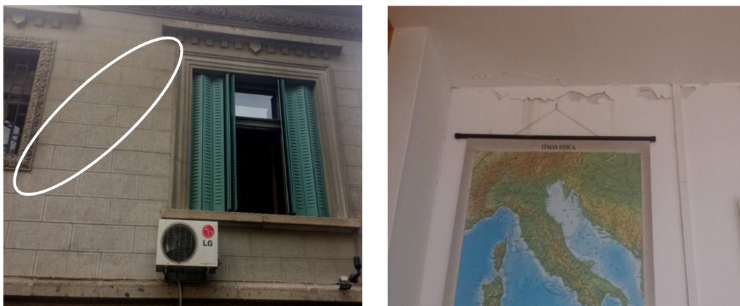
Сл. 3 Оштетувања на фасадните и внатрешните сидови од земјотресот на 11.09.2016
